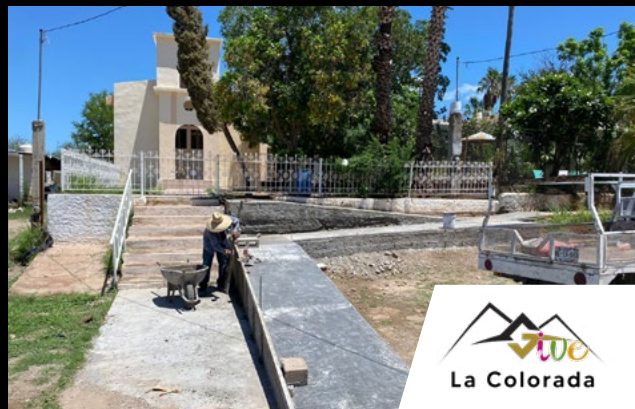
Argonaut Gold apoya la construcción de rampa, reparación e impermeabilización de la iglesia.
